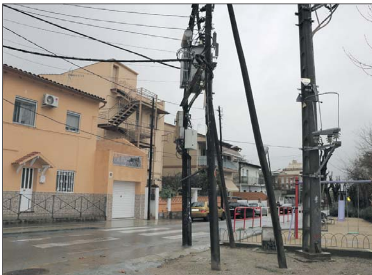
El transformador del carrer de Miguel Hernández.
